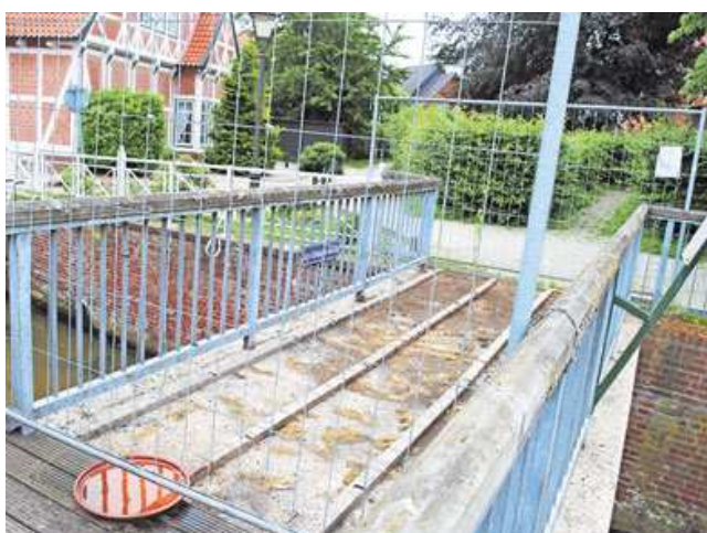
Todgeweiht: Blick auf die gesperrte Arp-Schnitger-Brücke über das Fleet in Jork.
